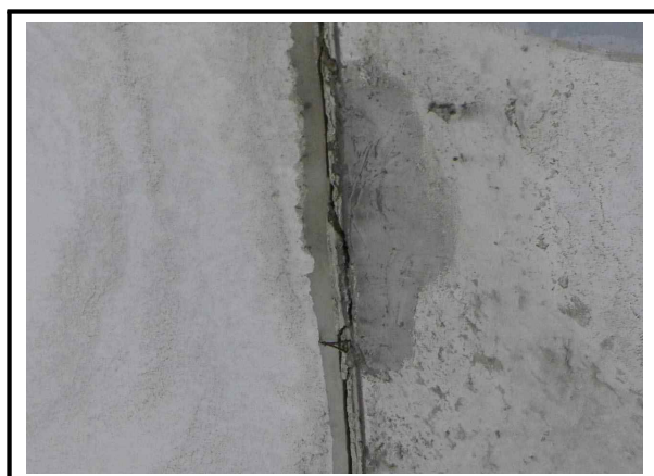
사진번호 34 천단부 S70(J70) 외관망도 15-10 조인트부 박락
