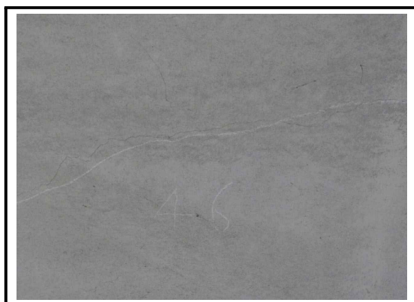
사진번호 24 천단부 S46 외관망도 10-20 균열(0.3mm미만)
