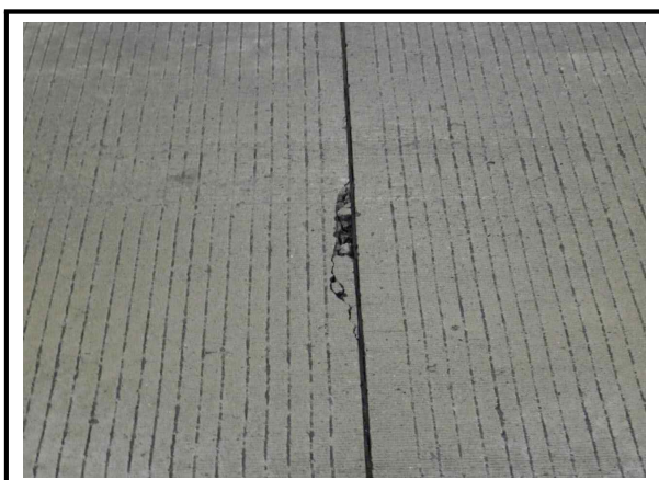
사진번호 63 포장부 S18 줄눈 주변 파손 외관망도 4-15
