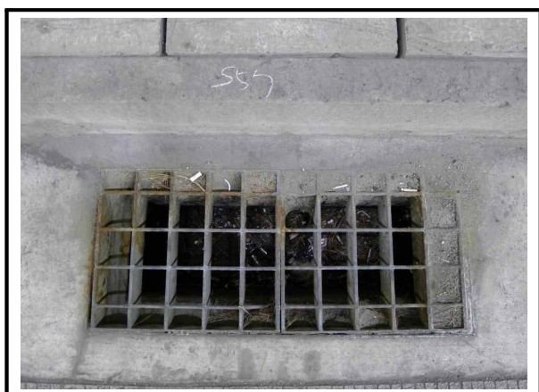
사진번호 48 집수구 S57 내부 이물질 퇴적 외관망도 12-13
