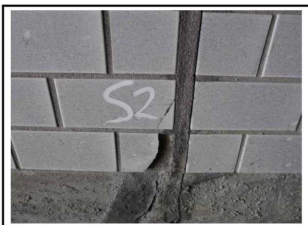
사진번호 35 측벽부 S2 좌측 타일탈락, 외관망도 1-1 파손
