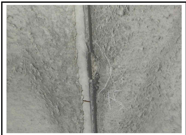
사진번호 19 천단부 S15(J15) 외관망도 3-19 시공이음부 박락
