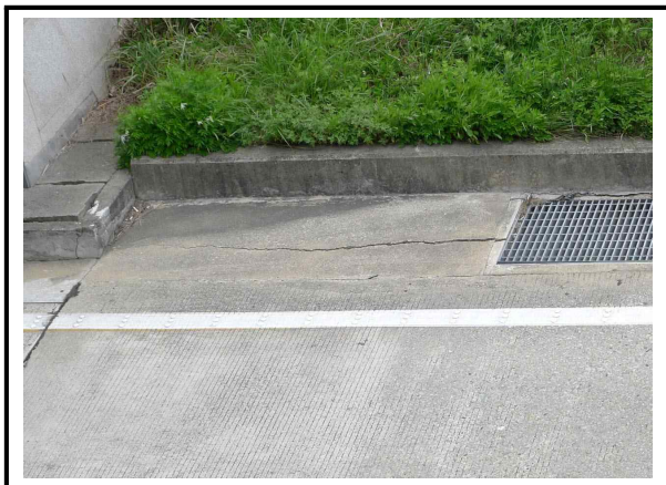
사진번호 61 포장부 S1 접속부 균열 외관망도 1-1
