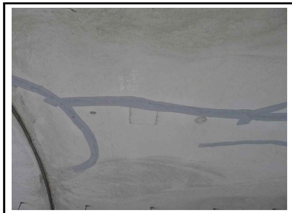
사진번호 32 천단부 S72 균열 외관망도 - 보수현황
