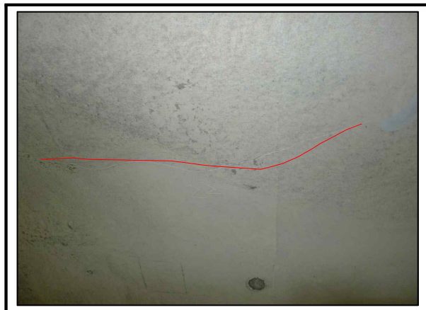
사진번호 20 천단부 S22 외관망도 5-16 균열(0.3mm미만)
