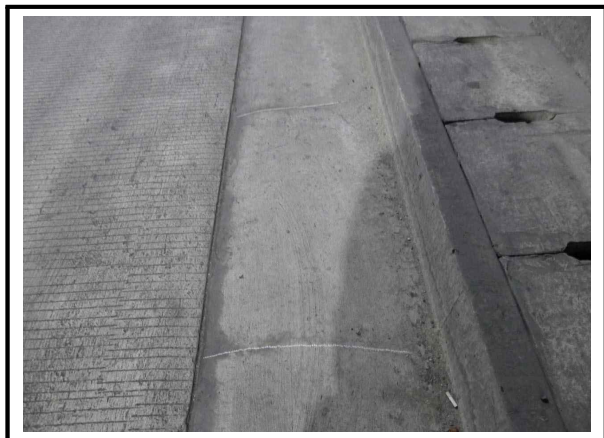
사진번호 44 측구 S16 균열(0.3mm미만) 외관망도 4-8
