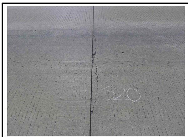
사진번호 64 포장부 S20 줄눈 주변 파손 외관망도 4-16
