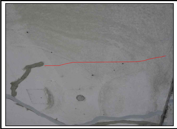
사진번호 25 천단부 S47 외관망도 10-1 균열(0.3mm 미만)
