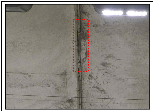
사진번호 31 천단부 S71(J71) 외관망도 15-10 시공이음부 박락
