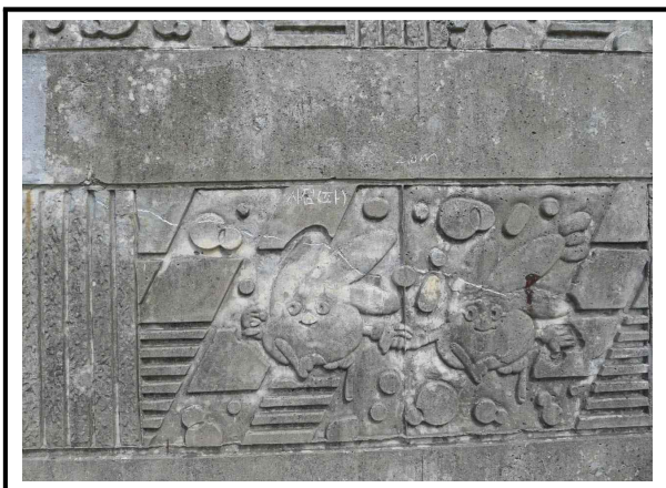
사진번호 69 갱구부 옹벽(시점 좌측) 균열(0.3mm 미만) 외관망도 16-2
