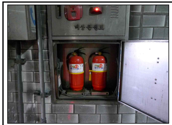
사진번호 84 소화시설 비치현황 외관망도 -
