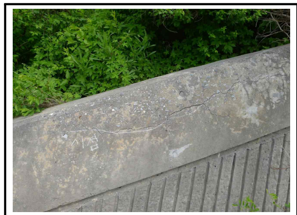
사진번호 70 갱구부 옹벽(시점 좌측) 균열(0.3mm 이상) 외관망도 16-2
