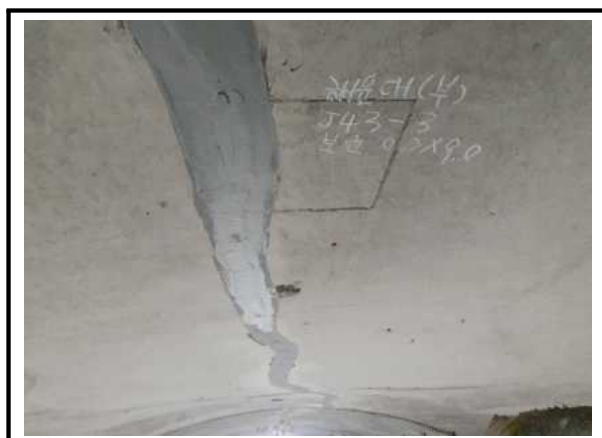
사진번호 22 천단부 S43 균열 외관망도 - 보수현황
