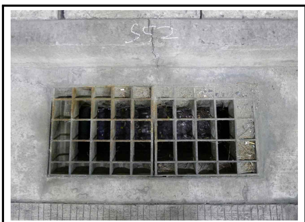
사진번호 47 집수구 S52 내부 이물질 퇴적 외관망도 11-13
