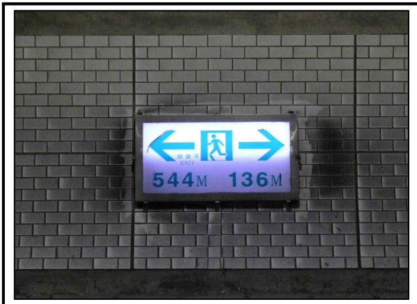
사진번호 81 비상구 표시등 설치현황 외관망도 -
