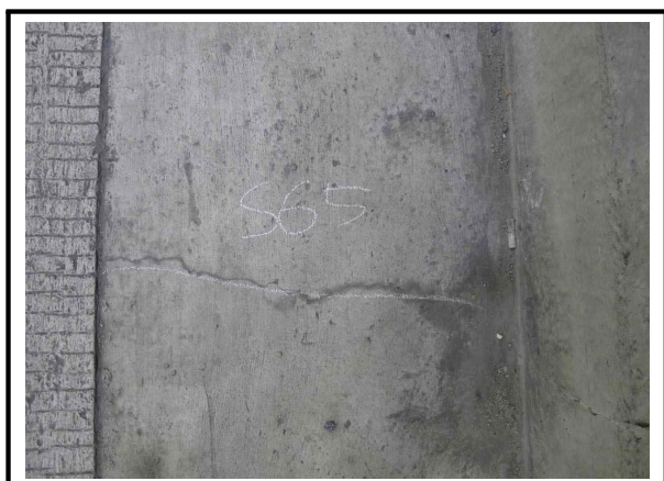
사진번호 46 측구 S65 균열(0.3mm미만) 외관망도 13-12
