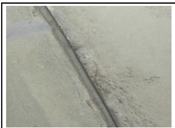
사진번호 33 천단부 S37(J37) 외관망도 8-11 조인트부 박락
