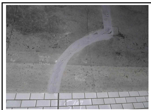
사진번호 36 측벽부 S19 균열 외관망도 - 보수현황
