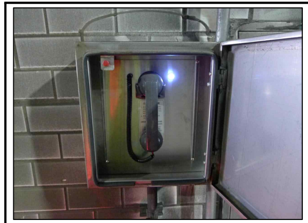
사진번호 82 비상전화시설 설치현황 외관망도 -
