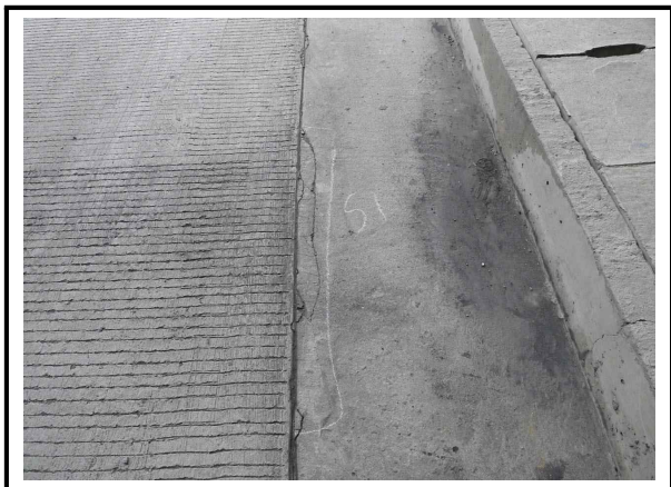
사진번호 43 측구 S1 좌측 파손 외관망도 1-9
