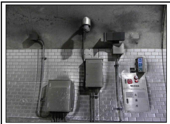
사진번호 83 터널 내부 CCTV 설치현황 외관망도 -
