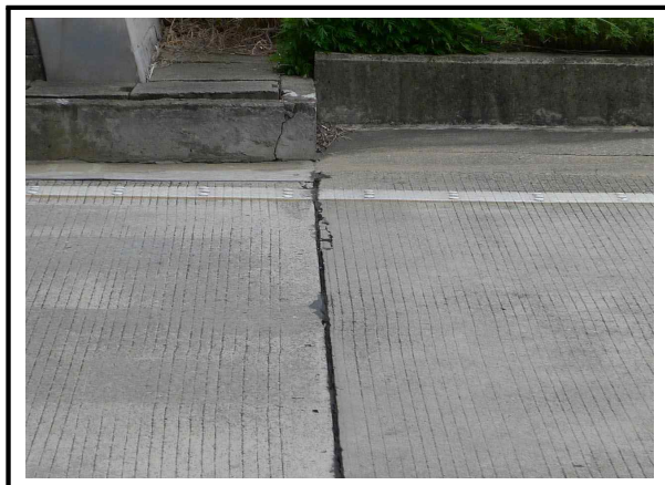
사진번호 62 포장부 S1 줄눈 주변 파손 외관망도 1-12
